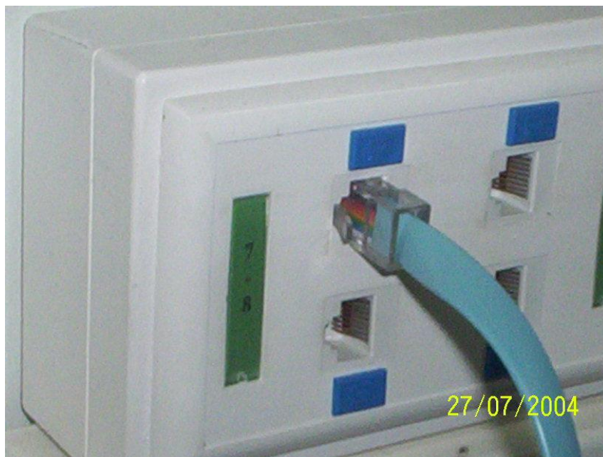
Figura 1.2: Cable de consola conectado al punto de red # 7
