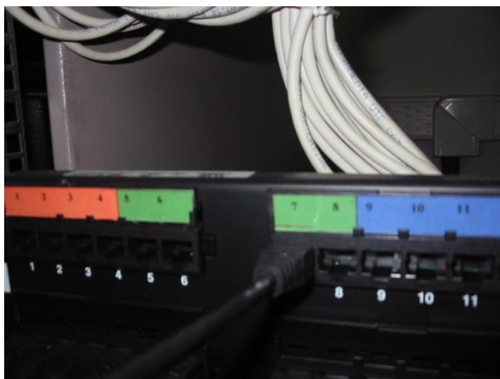
Figura 1.3: Cable derecho conectado al punto de red #7 del Patch Panel
